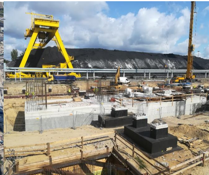
Blok gazowo-parowy w Elektrociepłowni Żerań
